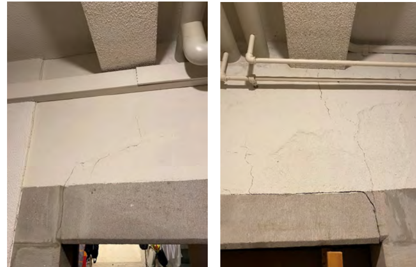
UG RISSE TÜRSTÜRZE (STEINGEWÄNDE)
