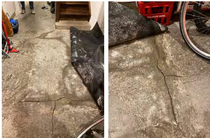
UG RISSE IN DER BODENPLATTE
