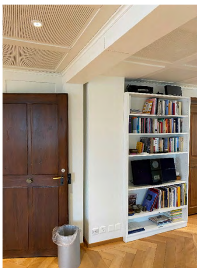
EG RISS IN UNTERZUG
