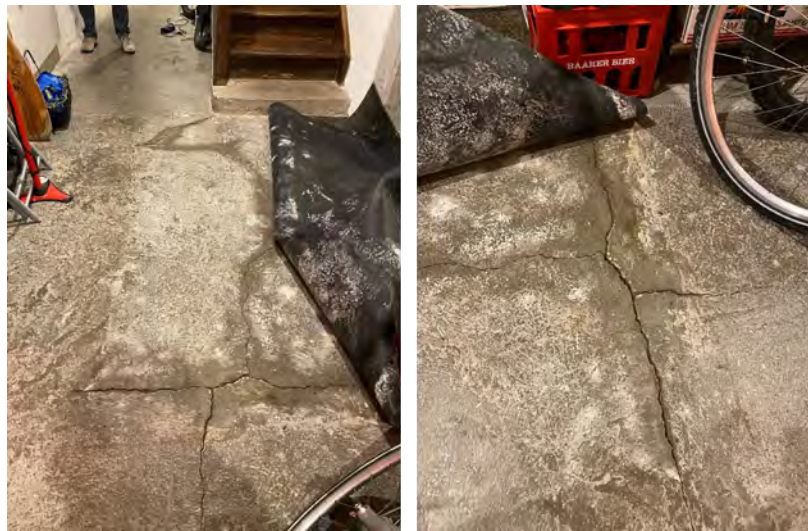
UG RISSE IN DER BODENPLATTE
